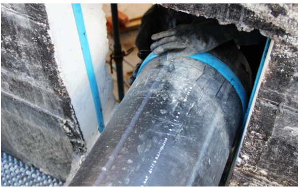
Рис. 13. Ущільнення вводів в будинок
