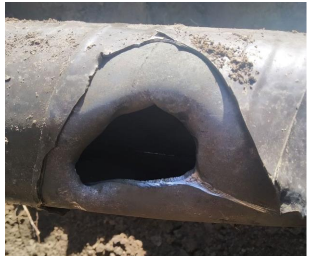
Рис. 4. Пошкодження сталевого газопроводу
