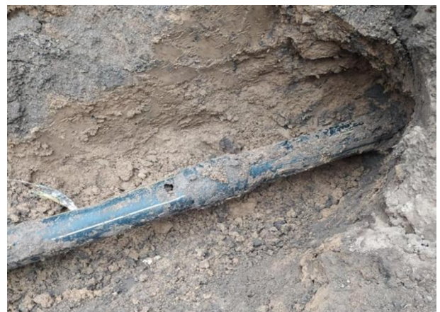
Рис. 5. Пошкодження поліетиленового газопроводу
