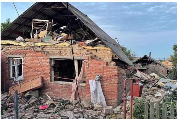
Рис. 2. Руйнування газифікованих приватних будівель
