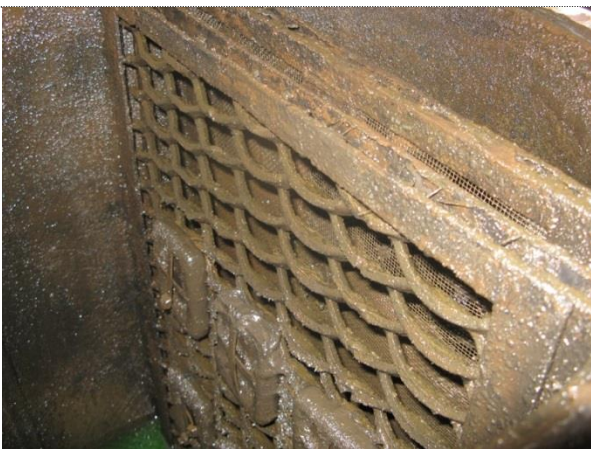
Рис. 4. Водна сторона димогарних труб конвективної частини котла ВК-32 (КСВа-2,5) після року роботи на «сирій» воді з реагентною обробкою
