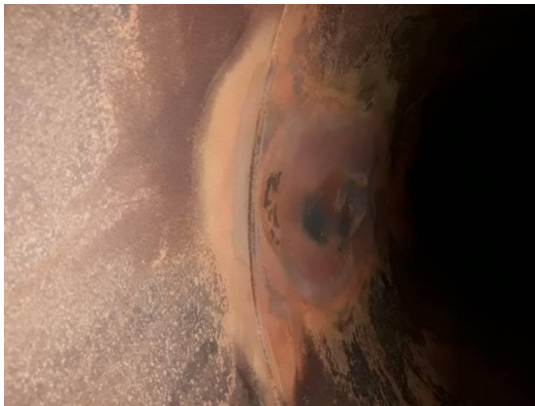
-Рис. 7. Котел Rielo RTQ-953 з зоною перегріву на верхній частині жарової труби
