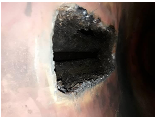
Рис. 8. Котел Rielo RTQ-953 з зоною перегріву, підготовленою до ремонту. Чітко видно відкладення шламу
