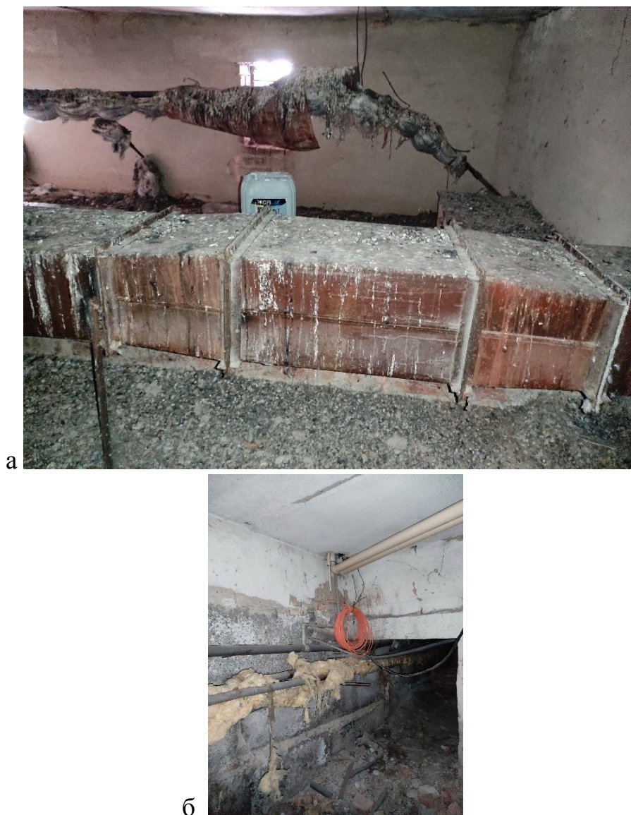
Рис. 1 Стан теплоізоляції магістральних трубопроводів навчального корпусу «Ф» а – на горищі; б – в приміщеннях підвалу
