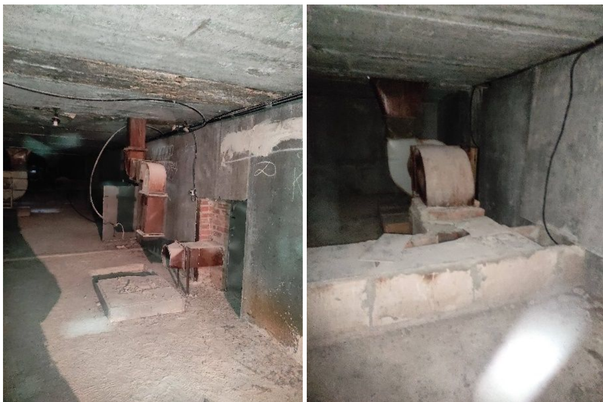
Рис. 7 Залишки механічних витяжних систем вентиляції (до реконструкції)
