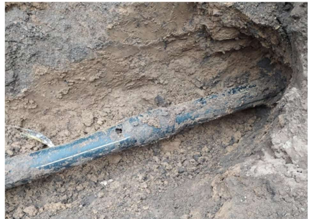
Рис. 5. Пошкодження поліетиленового газопроводу
