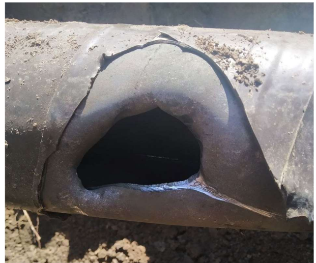
Рис. 4. Пошкодження сталевого газопроводу
