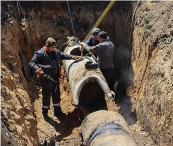
Рис. 6. Розкопка пошкодженого газопроводу
