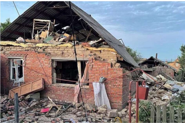
Рис. 2. Руйнування газифікованих приватних будівель
