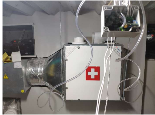
Рис.1. Вбудований фільтр Perfect 16 в існуючу систему повітроводів припливно-витяжної системи з під'єднаним датчиком перепаду тиску SPS-G-2KO.
