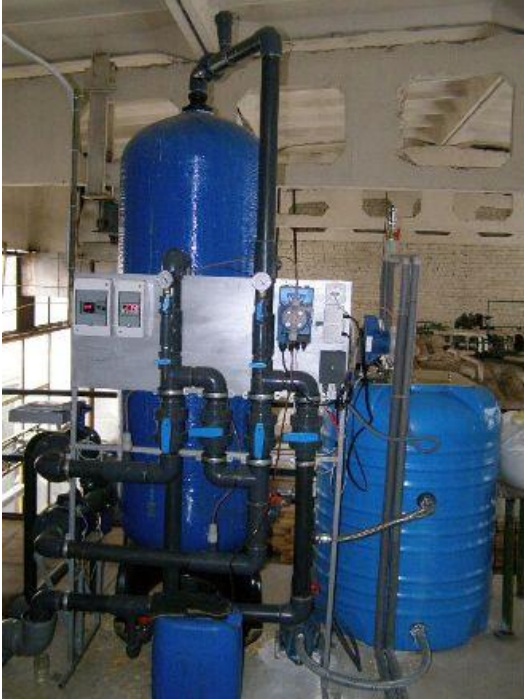
Рис. 6. Установа хімічної дегазації води Redox-KM
