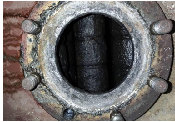
Рис. 19. Котел ВК-32 (КСВа-2,5), який пропрацював 14 років на воді без пом'якшення з реагентною обробкою
